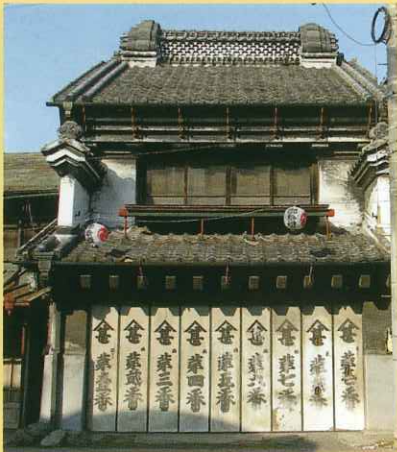
板戸で閉められている状態・修理前
